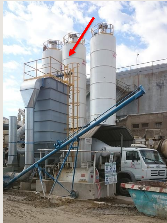
Sistema de aspiración y filtrado en planta de en vía seca
