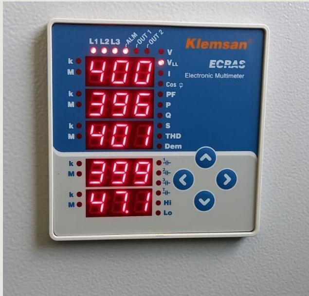
Amperímetro en panel de control de una planta de hormigón con mezcladora CONSTMACH
