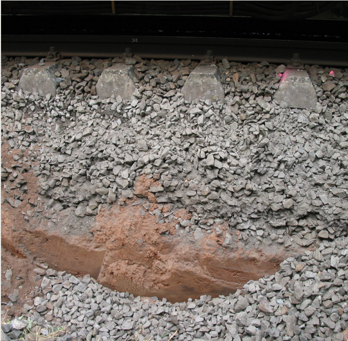
Disgregación y filtrado de finos bajo la capa de balasto
